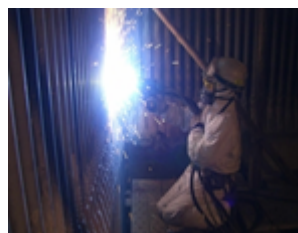
ボイラー (エネルギー、石油化学)
