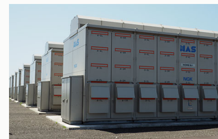
安定した電力供給へ蓄電池システムを活用
