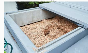
バイオマスボイラー
