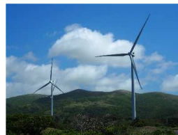
リエネ松前風力発電所 (北海道) 定格容量：41MW (2020年3月期運転開始)
