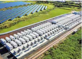
すずらん釧路町太陽光発電所の蓄電池 ※ 送配電線を介さずに自営線等で需要施設と発電所をつなぎ、直接電力供給を行う方法。「Power Purchase Agreement(電力販売契約)」の略
