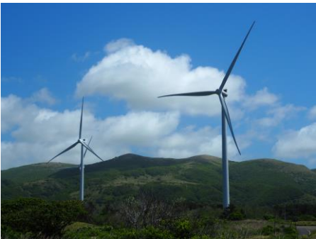
リエネ松前風力発電所
