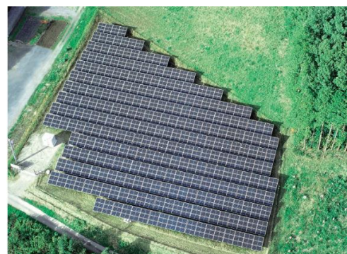
コーポレートPPA（オフサイト） 太陽光パネル
