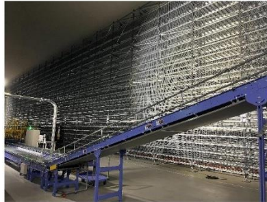
自動倉庫（高さ9.9m）
