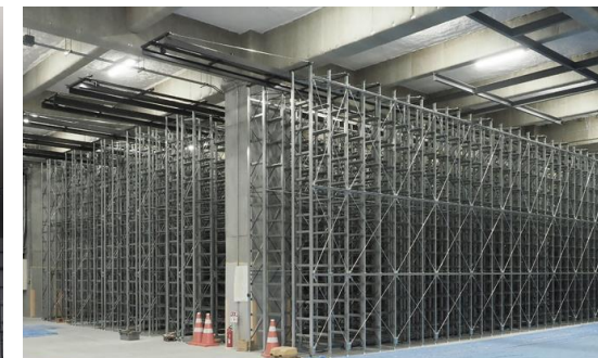
バケット自動倉庫
