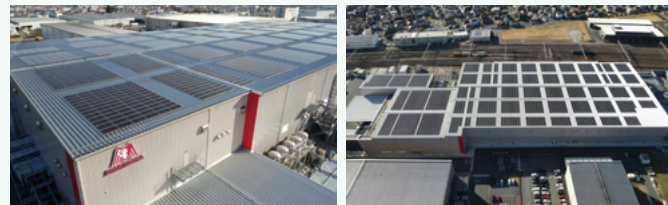
屋上太陽光発電パネルが設置された高崎森永(株)
