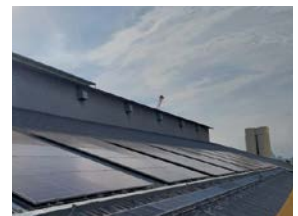
太陽光発電設備 日清STC製粉(タイ)ハルパデー工場
