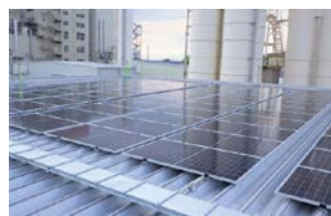
日清フーズ 館林工場で稼働する太陽光発電設備
