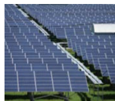
太陽光パネル
