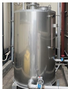
蒸気ボイラーの給水タンク イニシオフーズ東大阪工場
