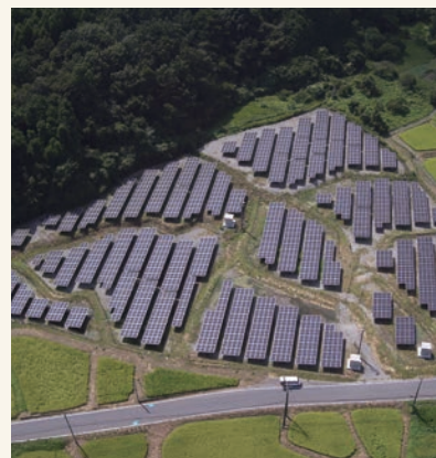
オフサイト太陽光発電施設の一部
