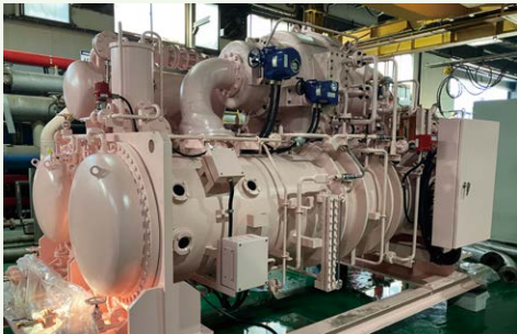
非常用ターボ冷凍機
