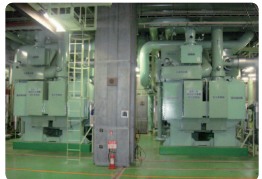
神戸ハーバランドエネルギーセンター(兵庫県)
