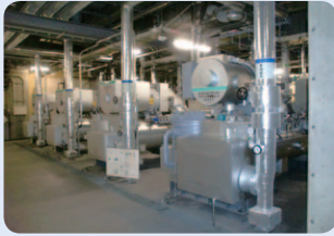
ターボ冷凍機
