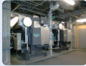
蒸気吸収冷凍機
