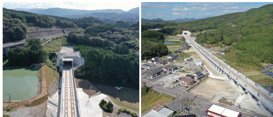
佐賀県武雄市 九州新幹線(西九州)、大草野トンネル外1箇所他
