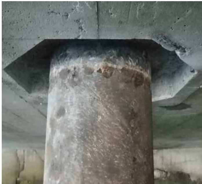
接合部の腐食状況
