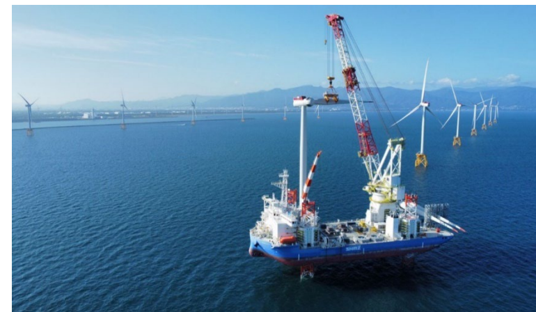
石狩湾新港洋上風力発電所 当社保有の自航式SEP船「BLUE WIND」で施工済
