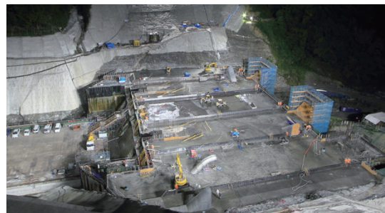
堤体の夜間照明に光の拡散を抑制するLEDを使用。民家への光害を防止した
