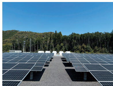
伊佐太陽光発電所併設蓄電所
