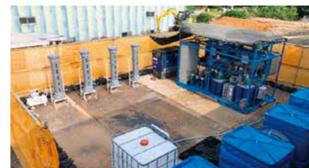
有機フッ素化合物(PFAS)汚水浄化実証施設(沖縄県)
