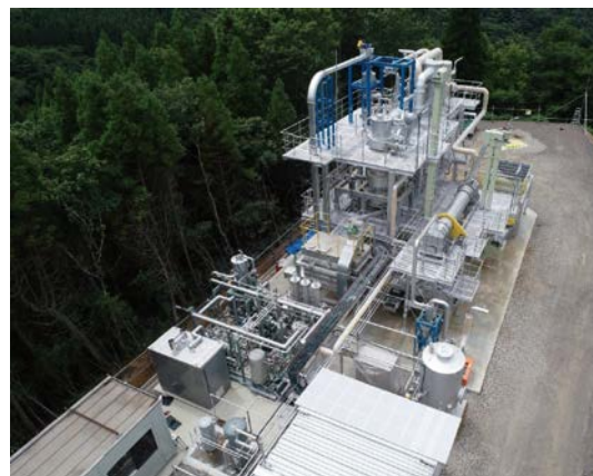
水素製造プラントの全景
