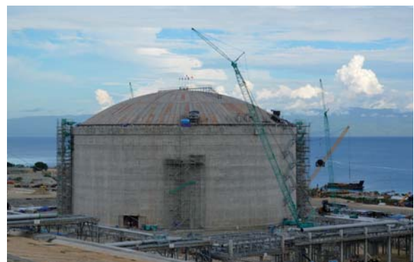
Donggi Senoro LNG Tank, Indonesia
