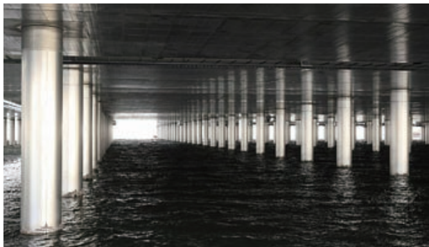
栈橋部は100年耐用とするため、チタンやステンレスの防食材や除湿システムが採用されている
