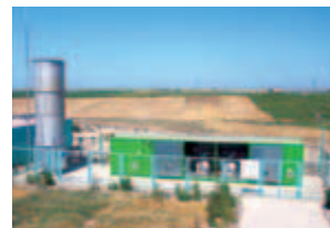
ウズベキスタン共和国タシケント市 メタンガス回収プラント
