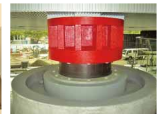
当社技術研究所 本館免震装置
