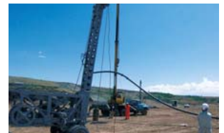
アルメニアで建設工事のメタンガス回収施設
