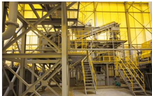
ダイオキシン類汚染土壌洗浄プラントの洗浄処理施設
