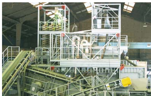
定置型土壌洗浄プラント(川崎土壌洗浄プラント事業所)
