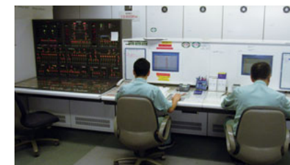
中央監視設備
