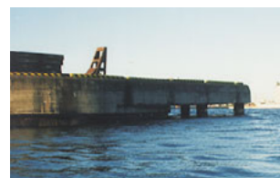
劣化した構造物
