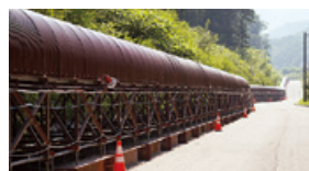
長さ約10kmの骨材運搬用のベルトコンベヤ
