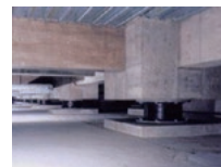
本館耐震改修工事で設置した免震装置
