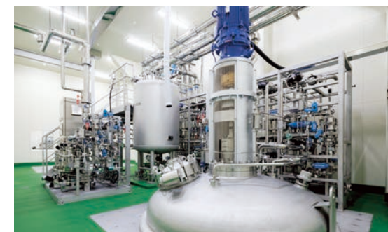
池田糖化工業 箕島工場 培養設備（広島県福山市）
