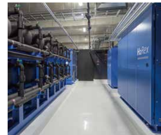
当社北陸支店で稼働中の「Hydro Q-BiC」
