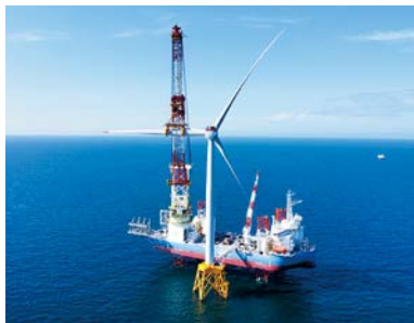
石狩湾新港洋上風力発電所 (SEP船)
