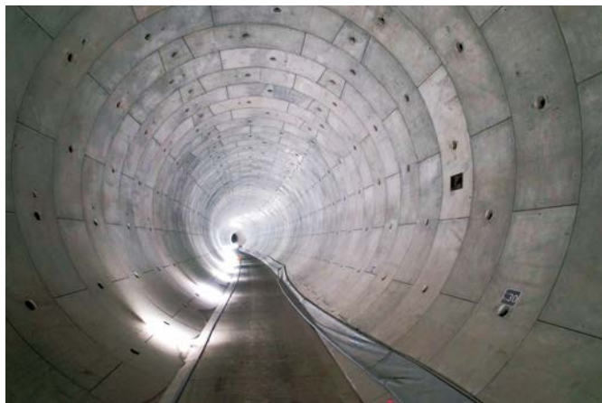
Hランプシールド(トンネル内)
