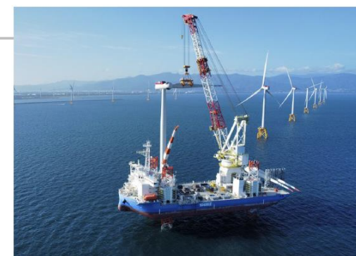
石狩湾新港洋上風力発電所
