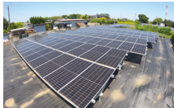
東急建設専用のNon-FIT低圧太陽光発電設備
