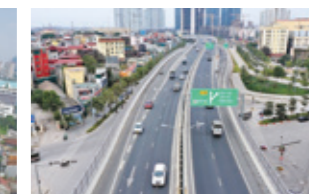
ハノイ市環状道路3号線整備事業（マイジック-南タンロン間）第2工区
