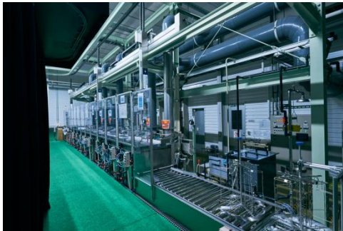
脱脂・エッチング付蛍光浸透探傷装置 (サクラソニック)
