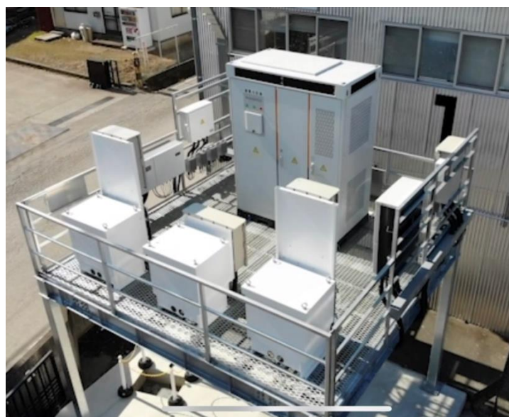
＜工場に設置した蓄電池＞
