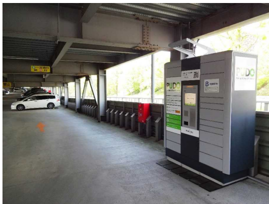
【南大沢駅前パークング(屋内設置)】
