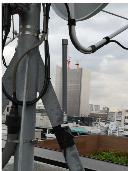
基地局: 八重洲ビル屋上
