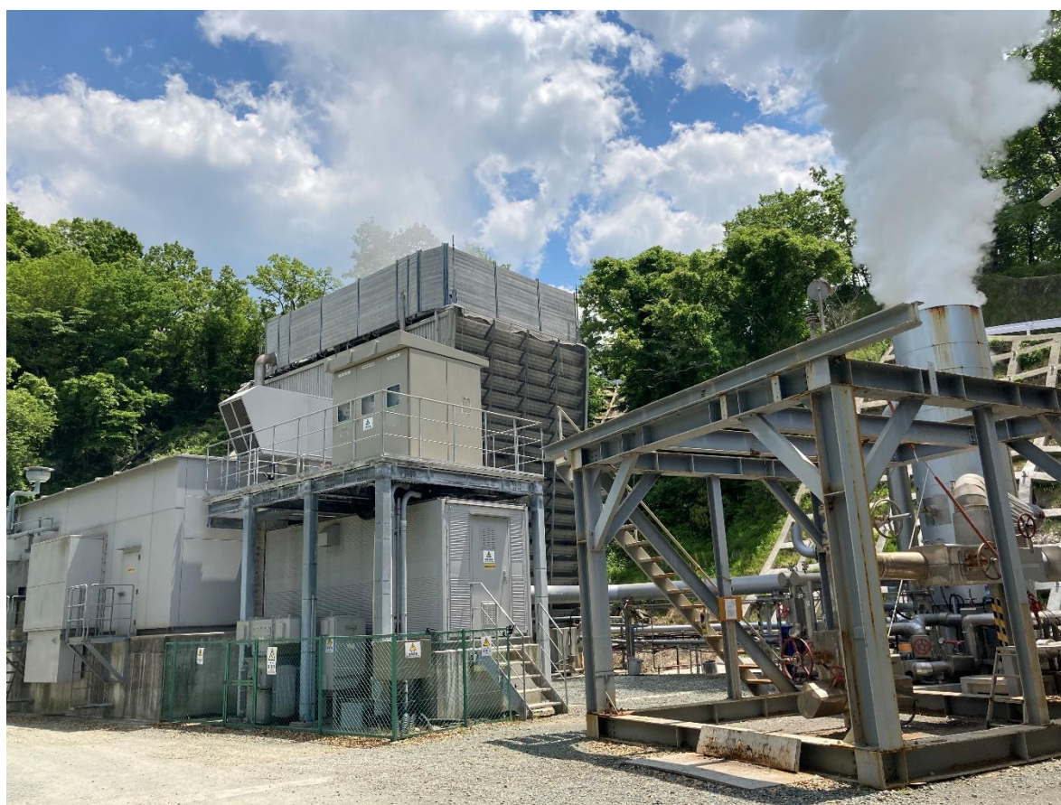
岳の湯地区にて既に稼働済みのわいた第1地熱発電所 (企画・開発 わいた会・ふるさと熱電)
