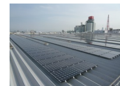
ビール工場太陽光パネル
